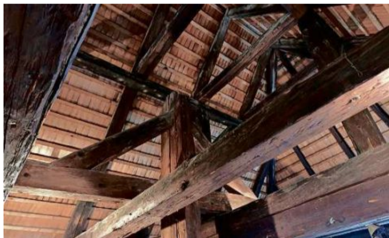
Historisches Dachgeschoss: Das Holz des Dachstuhls soll dort bereits vor über 450 Jahren eingebaut worden sein.
